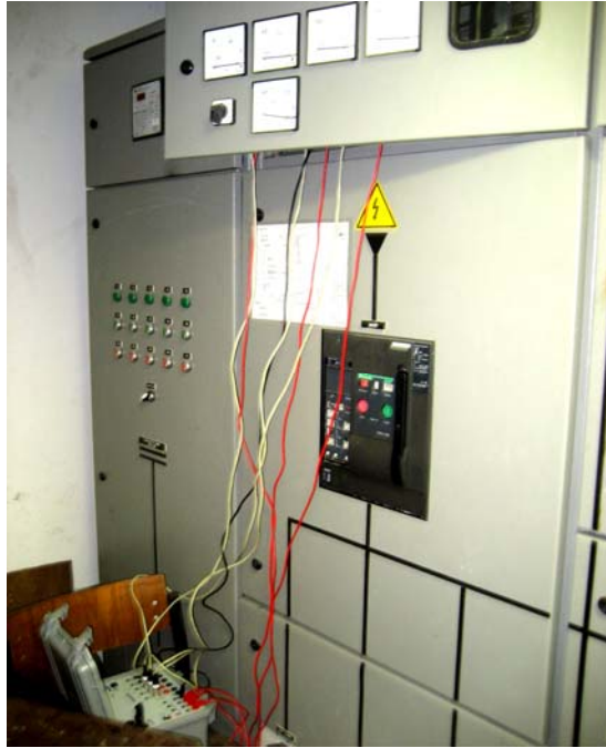
ภาพที่ 4. การติดตั้งเครื่องวัดคุณภาพไฟฟ้า
