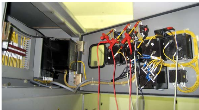
ภาพที่ 2. การต่อสายเครื่องวัดคุณภาพไฟฟ้าเข้ากับระบบไฟฟ้าภายในอาคาร
